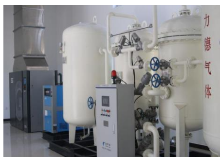
2 氮气气调储粮制氮设备
