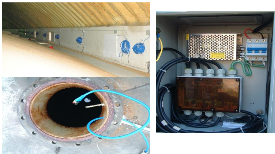
CGSR-GDCS IV 型粮情测控系统组成
