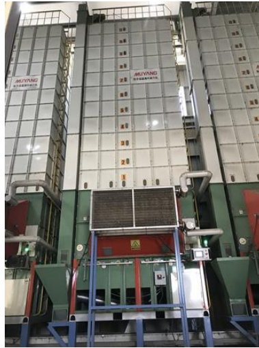
图 3-5 蒸汽换热设备
