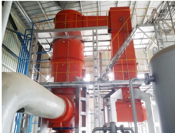
图 5-1 生物质富氧高温气化燃烧炉本体
