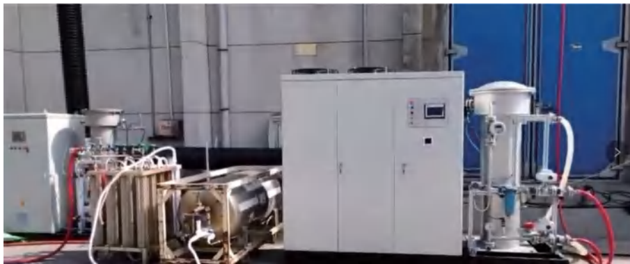
臭氧储粮装置工作中
